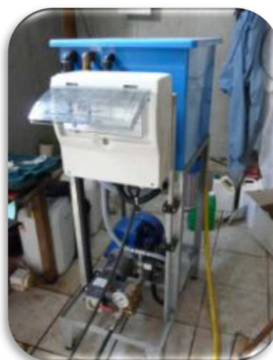
Figure 22 : Pompe pour la rampe de brume HP servant à détremper le bâtiment
