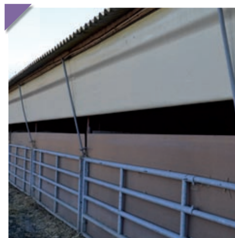
Entrée d'air au-dessus de la barrière, rideaux indépendants pour chaque salle.
