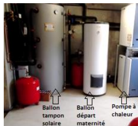
Photo 3 – Vue intérieure de l'installation de chauffage
