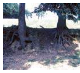
Déchaussement de la haie et dégradation du talus dû au piétinement des animaux (absence de clôture)
